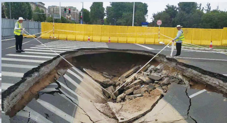
遵大路银港大道交叉口处塌陷
