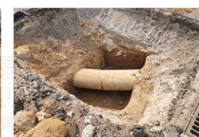
路基回填不实不均匀沉降导致管网破损
