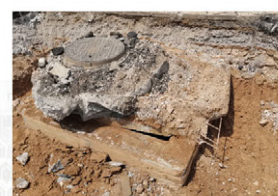
因检查井盖错口导致土体流失
